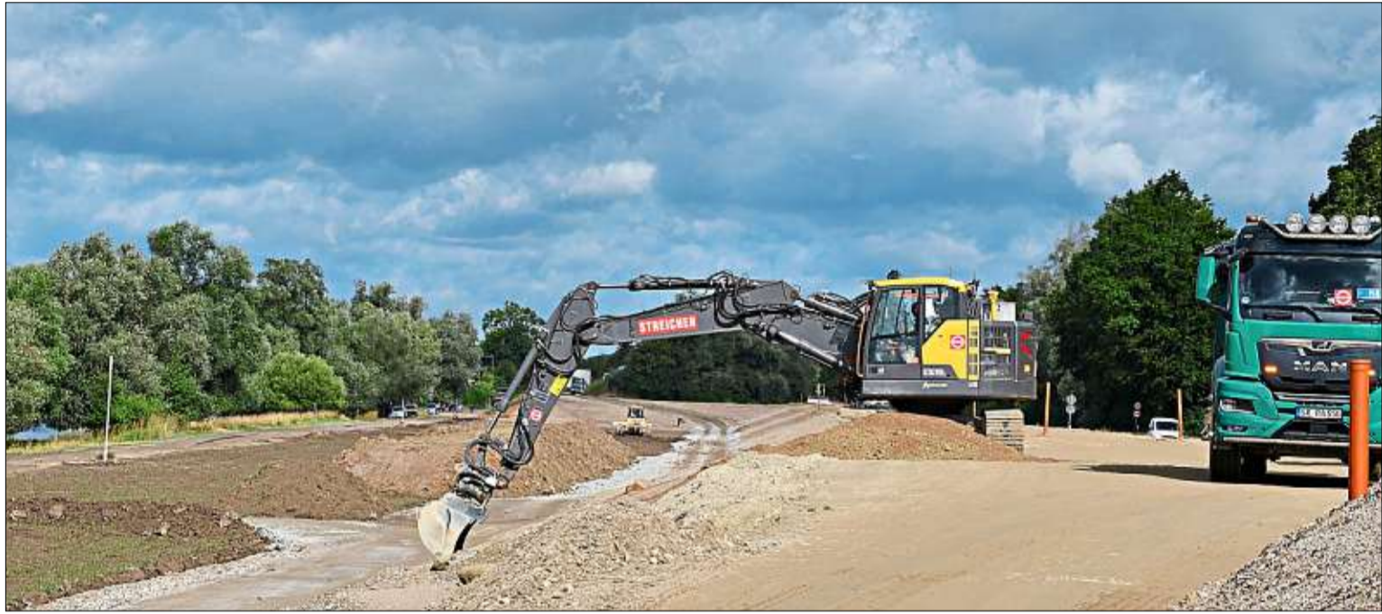
Baggerarbeiten am neuen Deich Metten-Ost: Der Schutzwall verläuft nun direkt an der Staatsstraße, der alte (links) wurde bereits abgetragen. Durch die Rückverlegung entsteht mehr Vorland, das der Donau bei Hochwasser mehr Platz lässt. – Fotos: Wendelin Trs
