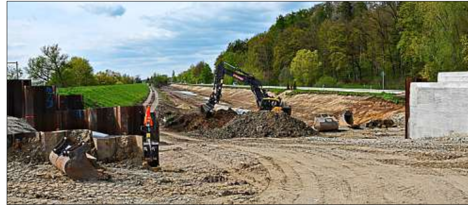
Oberhalb von Schalterbach steht der alte Deich noch. Hier laufen erste Vorbereitungen zur Schüttung entlang der Straße. – Fotos: Gabriel
