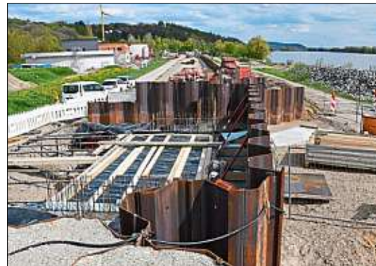
Spundwände stellen sicher, dass der Hochwasserschutz auch während der Bauarbeiten stets gewährleistet ist. Auf Höhe des Mettener Kreisverkehrs wird eine Zufahrt ins Vorland gebaut.
