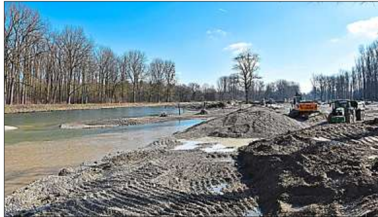
Schweres Gerät ist nötig , um die Renaturierungsarbeiten parallel zum Strom der Isar durchzuführen.
