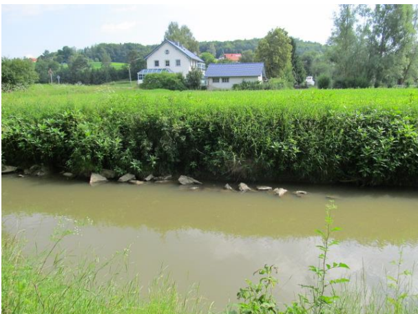
Bild 7: Wolfach bei Fluss-km 9,400 bei Neustift Begradigter und befestigter Uferlauf, z. T. bereits hinterspülte Ufersicherungen
