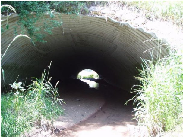
Bild 6: Breiter Durchlass mit Uferstreifen im Mittelwasserbereich am Sausbach bei Annathal
