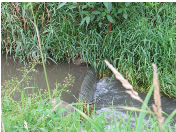
Bild 3: Absturz im Wolfachflutkanal
