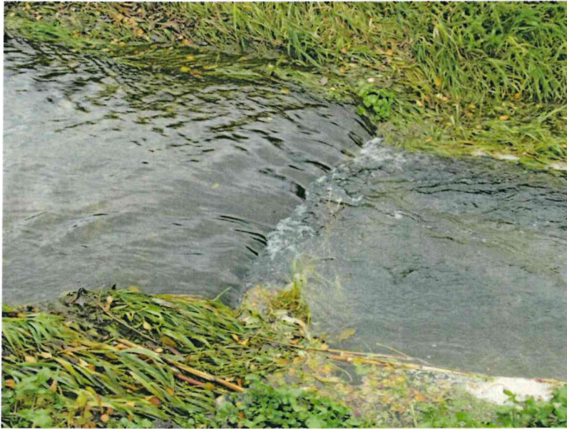
Abb. 2: Sohlschwelle am Reißinger Bach
