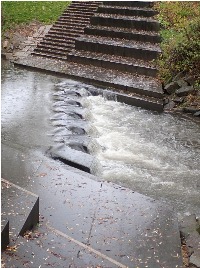
Abbildung 1: Nicht durchgängiger Absturz am Bogenbach kurz vor der Mündung in die Donau (Stadtgebiet DEG)
